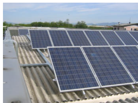
l'impianto fotovoltaico da 13 kW
