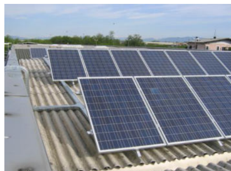
l'impianto fotovoltaico da 13 kW
