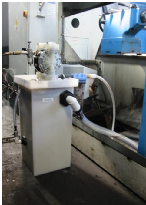
Depuratore-disoleatore MIXI in funzione
