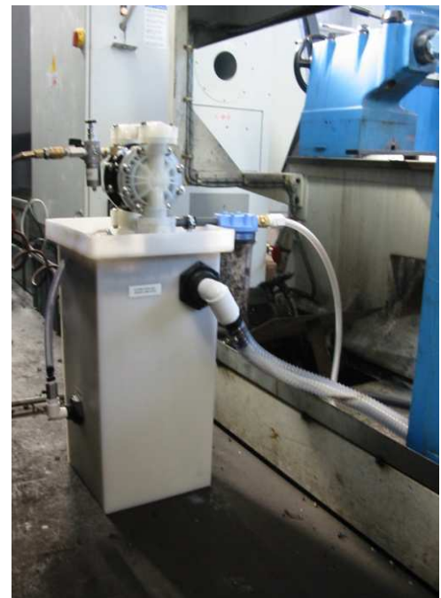
Depuratore-disoleatore MIXI in funzione
