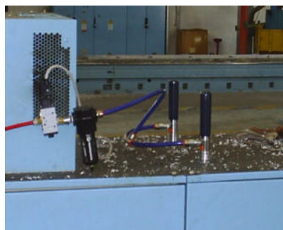
Condizionatori Exair 4030 su quadro elettrico di un'alesatrice
