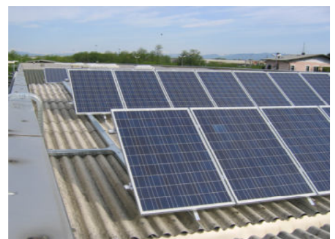
l'impianto fotovoltaico da 13 kW
