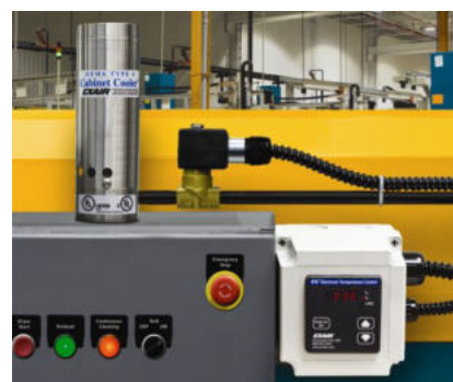
Controllo elettronico della temperatura ETC codice 9239
