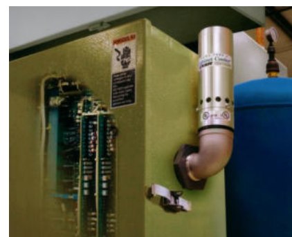
Condizionatore Exair 4630 installato sulla parete dell'armadio
