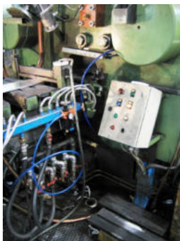
Separazione ambienti generatore installato su bocca di un forno
