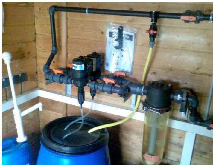
Impianto di miscelazione fertilizzanti
