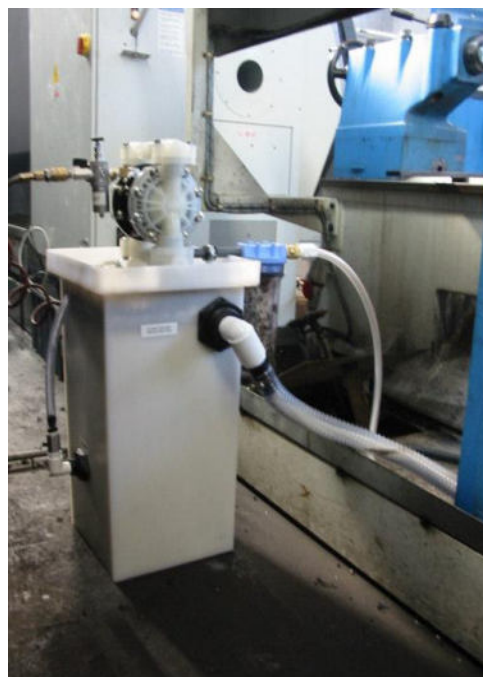
Depuratore-disoleatore MIXI in funzione
