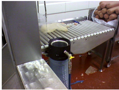
Aspirazione e trasporto di scarti provenienti da lavorazioni alimentari
