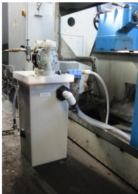
Depuratore-disoleatore MIXI in funzione
