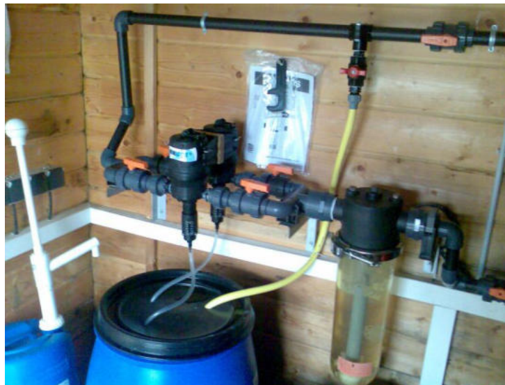
Impianto di miscelazione fertilizzanti
