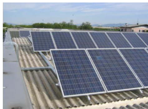
l'impianto fotovoltaico da 13 kW
