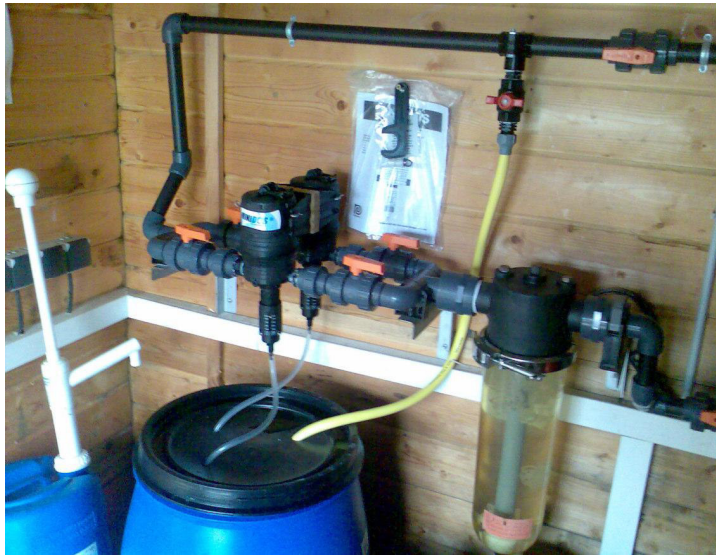
Impianto di miscelazione fertilizzanti
