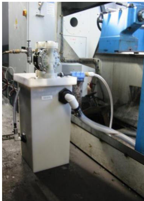
Depuratore-disoleatore MIXI in funzione
