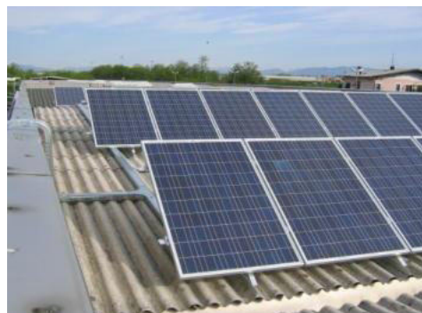
l'impianto fotovoltaico da 13 kW
