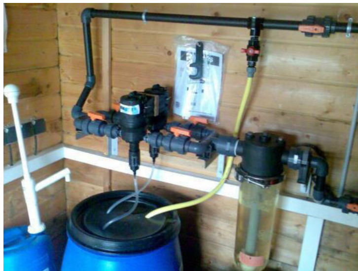
Impianto di miscelazione fertilizzanti
