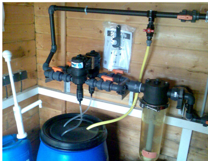
Impianto di miscelazione fertilizzanti
