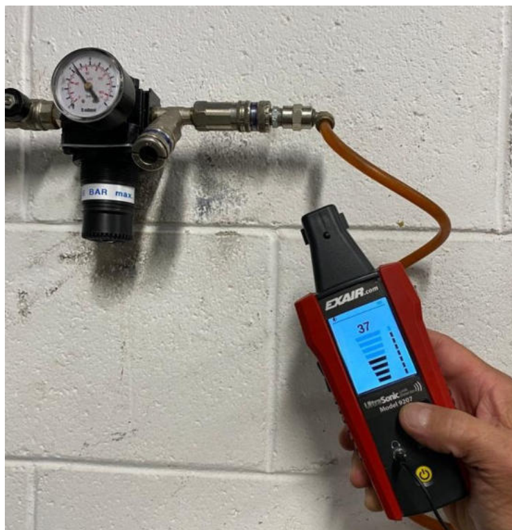
Verifica perdite da raccordi pneumatici
