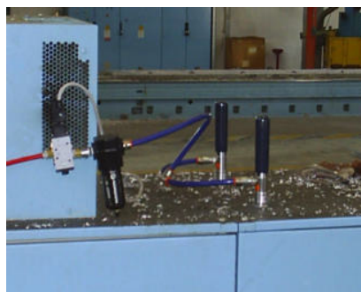
Condizionatori Exair 4030 su quadro elettrico di un'alesatrice
