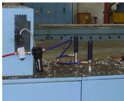
Condizionatori Exair 4030 su quadro elettrico di un'alesatrice
