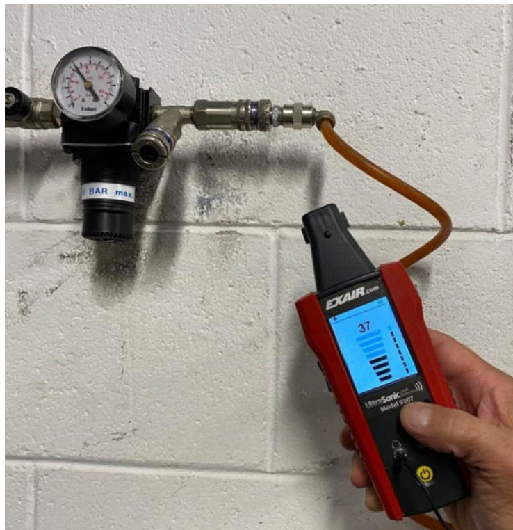
Verifica perdite da raccordi pneumatici
