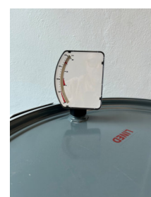
Installazione indicatore di livello
