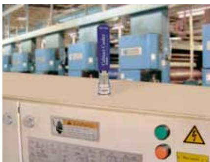
Condizionatore Exair 4040 su quadro elettrico di un impianto
