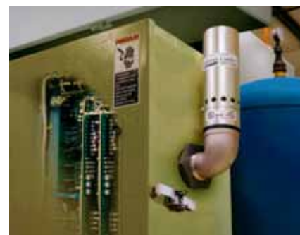
Condizionatore Exair 4630 installato sulla parete dell'armadio
