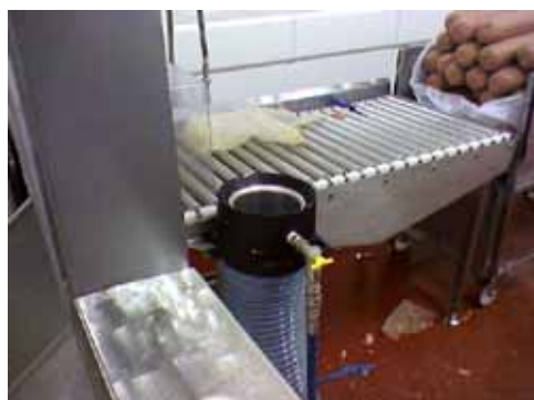
Aspirazione e trasporto di scarti provenienti da lavorazioni alimentari
