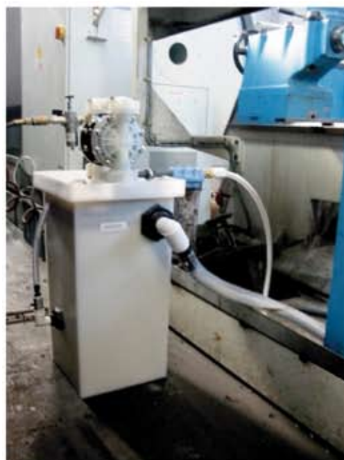
Depuratore - disoleatore MIXI in funzione
