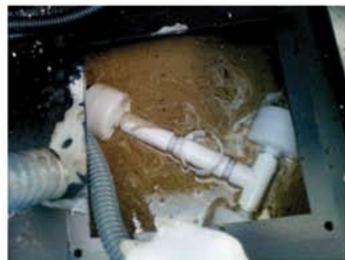
Pescante galleggiante in vasca prima della depurazione
